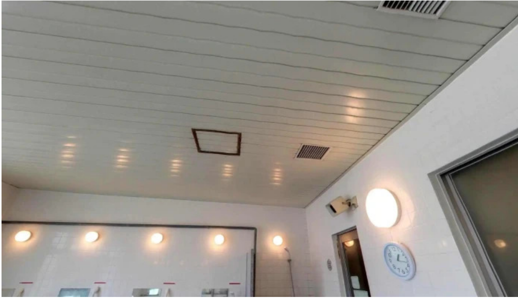
レストイン時之栖 設備
